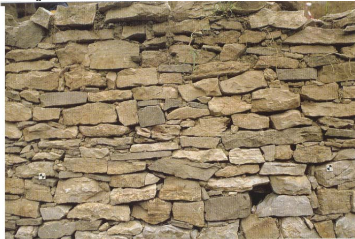
Abb. 3: Eine Teilansicht der Trockenmauer zeigt die sorgfältige Setzung des Mauerwerks, Die helleren Steine in den unteren Lagen stammen aus dem Mauerwerk des Vorgängerbaus.
