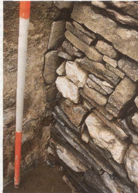
Bild 8: Eine der beiden Trennmauern zwischen einer Quellkammer und der Entnahmekammer belegt die sorgfältige Bauausführung der Brunnenstube »Alte Quelle«
